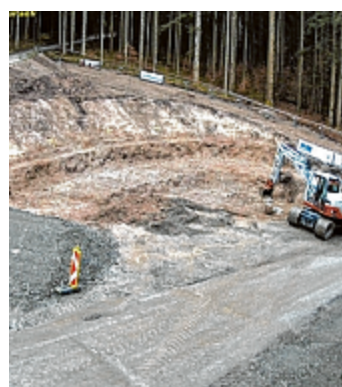
Der Bau des Hochbehälters in Buch läuft auf Hochtouren. Foto: Gem. Buch i. T.
